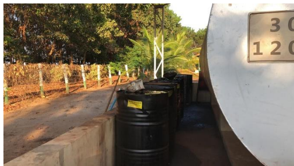
Figura 3: Bacia de Contenção do posto de combustível na Fazenda 2.
